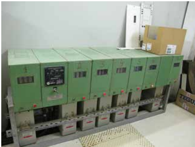
Figura 22. Baterías de condensadores.
