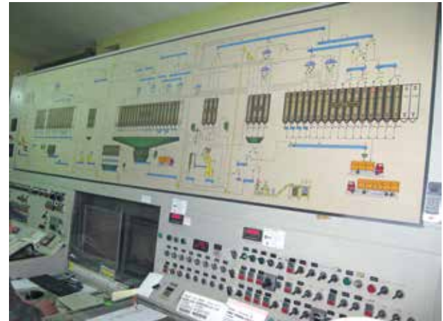
Figura 23. Panel de control.
