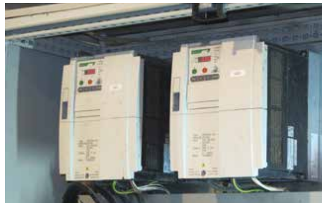
Figura 19. Variadores de velocidad.
