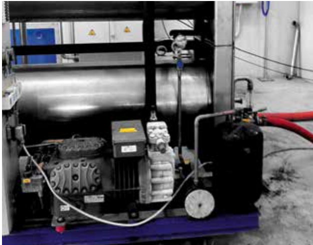
Figura 5. Equipamiento de frío para estabilización.
