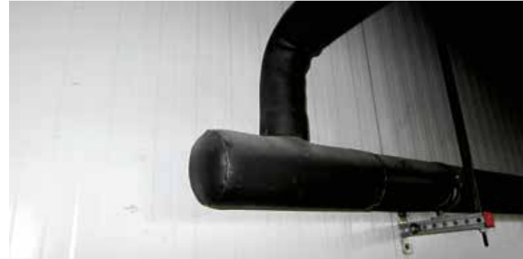
Figura 12. Aislamiento de tuberías en buenas condiciones.
