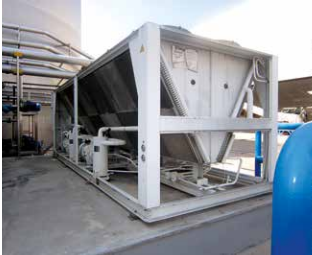
Figura 8. Equipo de enfriamiento.
