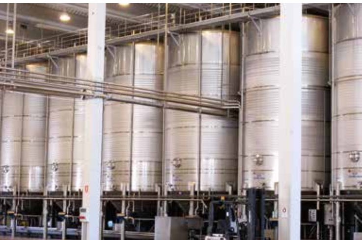
Figura 3. Tanques de fermentación.
