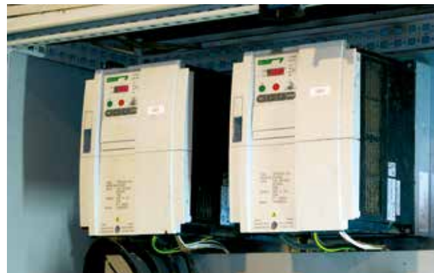
Figura 11. Variador de velocidad.
