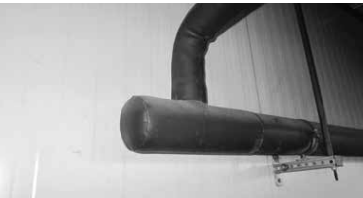
Figura 16. Aislamiento de tuberías en buenas condiciones.
