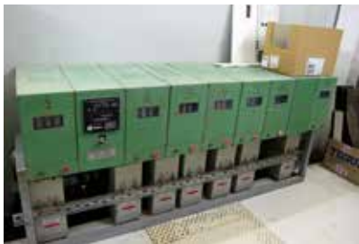
Figura 13. Batterie di condensatori.
