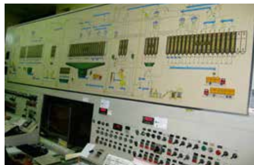
Figura 14. Pannello di controllo.
