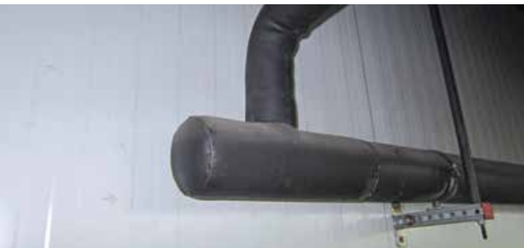
Figura 20. Isolamento dei tubi in buone condizioni.
