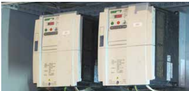
Figura 19. Variatori di velocità (variable speed drives, VSD).
