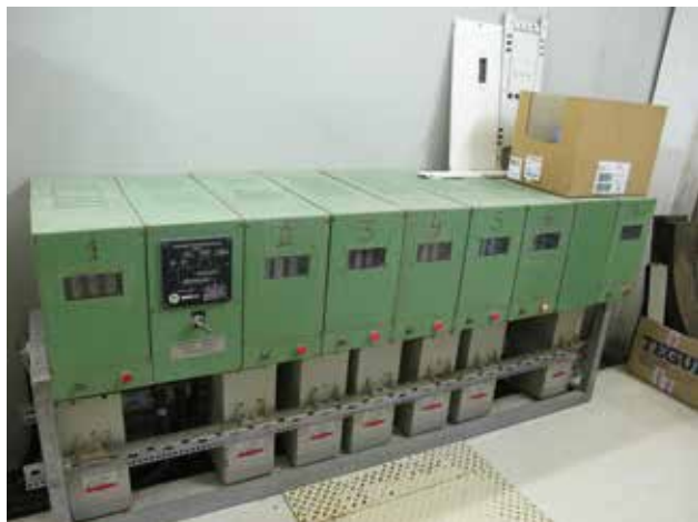
Figura 22. Batterie di condensatori.
