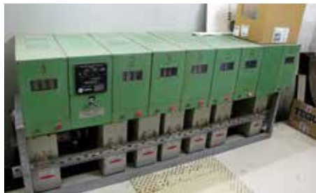
Figura 13. Baterias de condensação.
