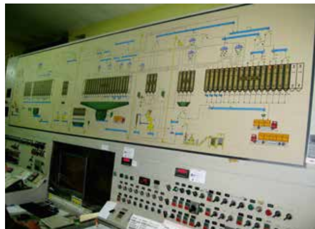
Figura 14. Painel de controlo.
