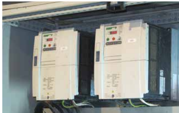
Figura 19. Variadores de velocidad.
