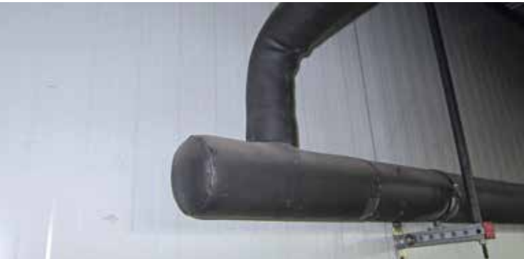
Figura 20. Aislamiento de una tubería en buenas condiciones.
