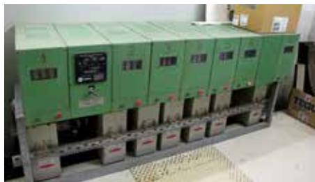
Figura 13. Batería de condensadores.
