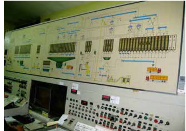
Figura 14. Panel de control.
